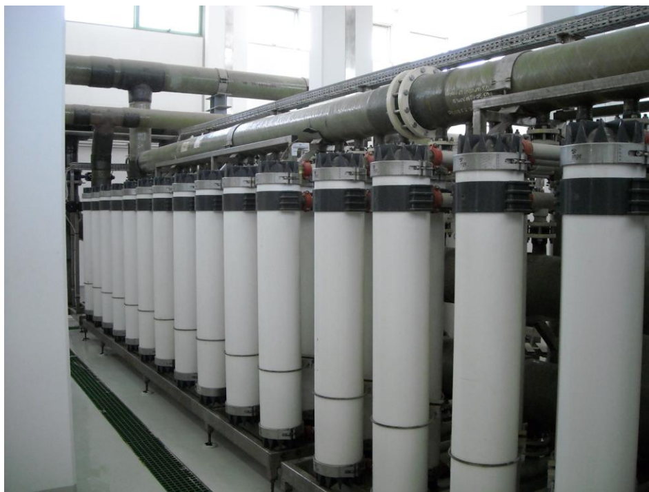
Bildunterschrift: Ultrafiltrationsanlage von inge watertechnologies AG in Abu Dhabi wird 80.000 m 3 Wasser pro Tag aufbereiten
